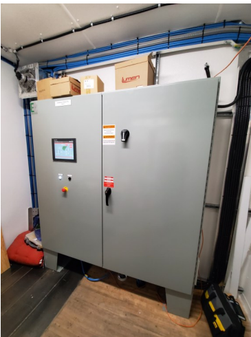
Panneau contrôle principal
