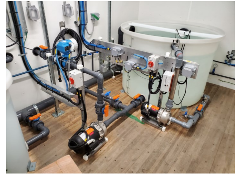
Bassin eau dégrillée / Système pompage
