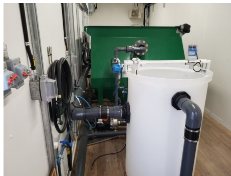
Décanteur lamellaire / Bassin tampon
