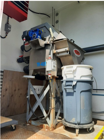
Dégrilleur tambour 2 mm
