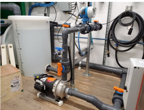
Système pompage / Bassin eau traitée
